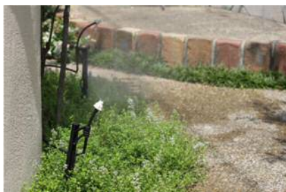
自動散水システム
