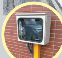
監視モニター
